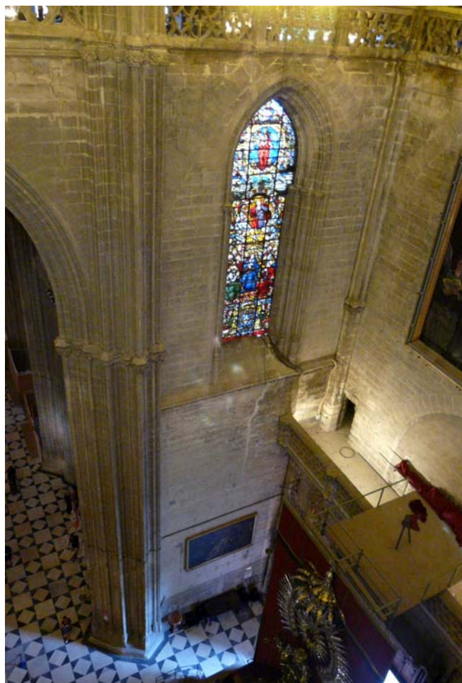
Fig. 6- Fotografía grietas junto a la puerta de la Concepción.
